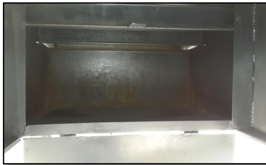
Figura 5.53. Interior de la caja.
