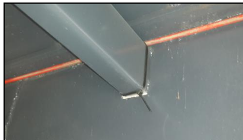
Figura 5.30. Manguera sujeta a travesaños
