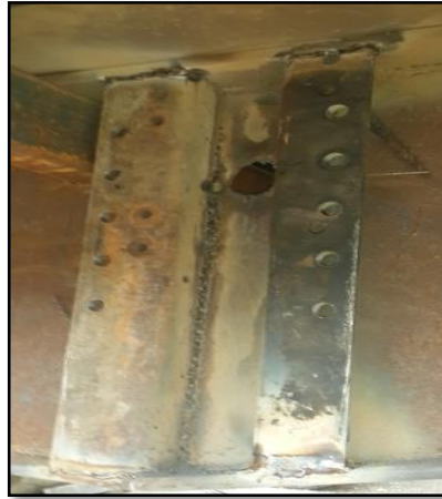
Figura 5.42. Soporte soldados a estructura.
