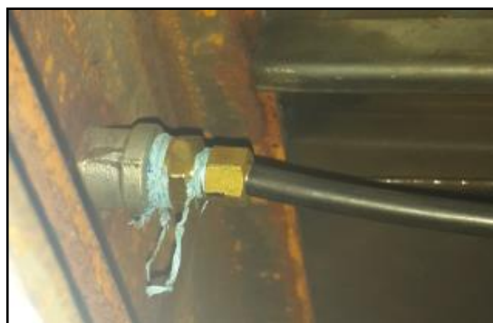
Figura 5.31. Manguera sujeta a travesaños
