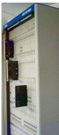
Figura. 3. 18. Controlador de la estación base
