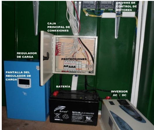
Figura 6: Equipos implementados dentro de la caseta Elaborado por: Herrera - Mullo
