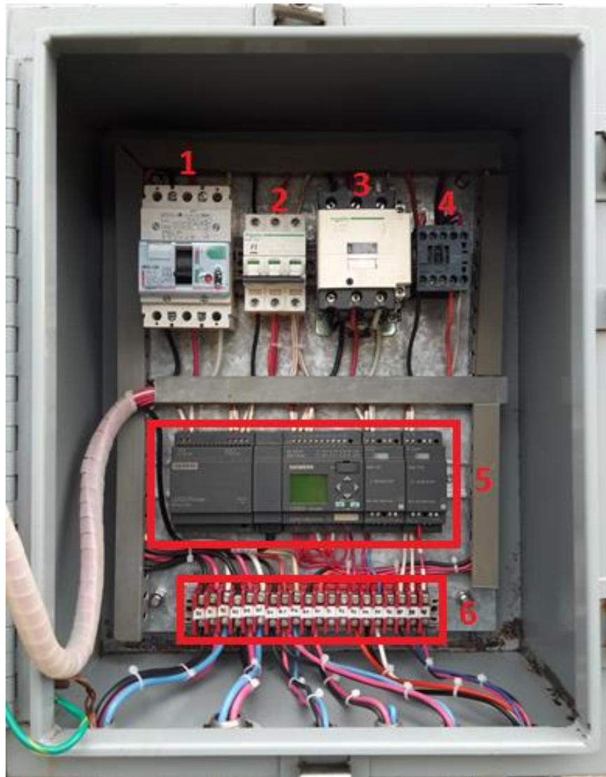
Figura 3.31. Parte interior del gabinete de control
