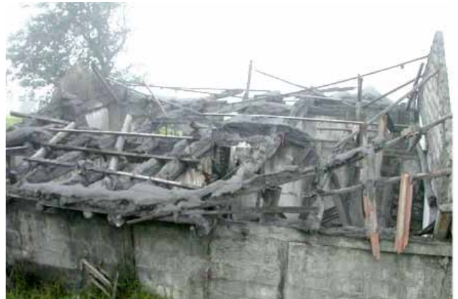
Fig. 1.46, Techos colapsados (Cerca de Baños de Agua Santa, Ecuador, 2002, Cortesia Mario Cruz)
