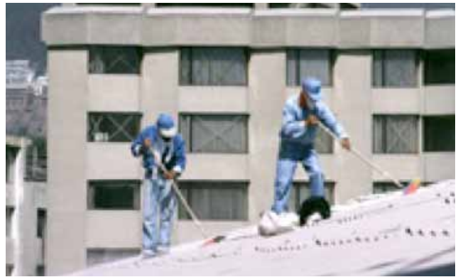
Fig. 1.44, Limpiadores encima de techos, que eventualmente cayeron de los mismos (Ecuador, 1999, Cortesia El Comercio)
