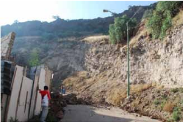
Fig. 4.10, Zona de Taludes Inestables en el Peñón del Marques.
