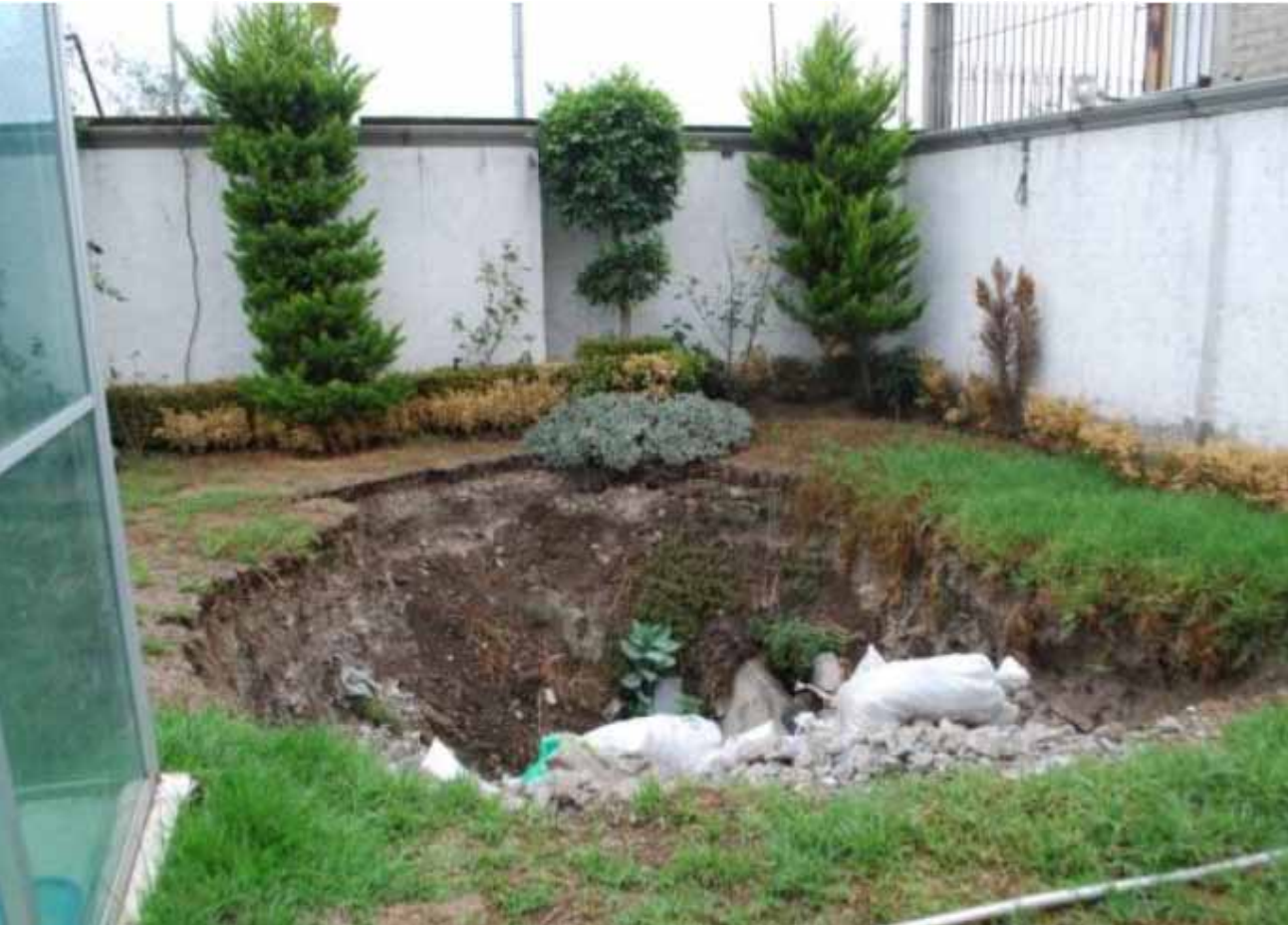
Fig. 4.12, Afectación de una vivienda producida por el colapso de material al interior de la Cueva la Colmena ocurrido en Septiembre del 2011.
