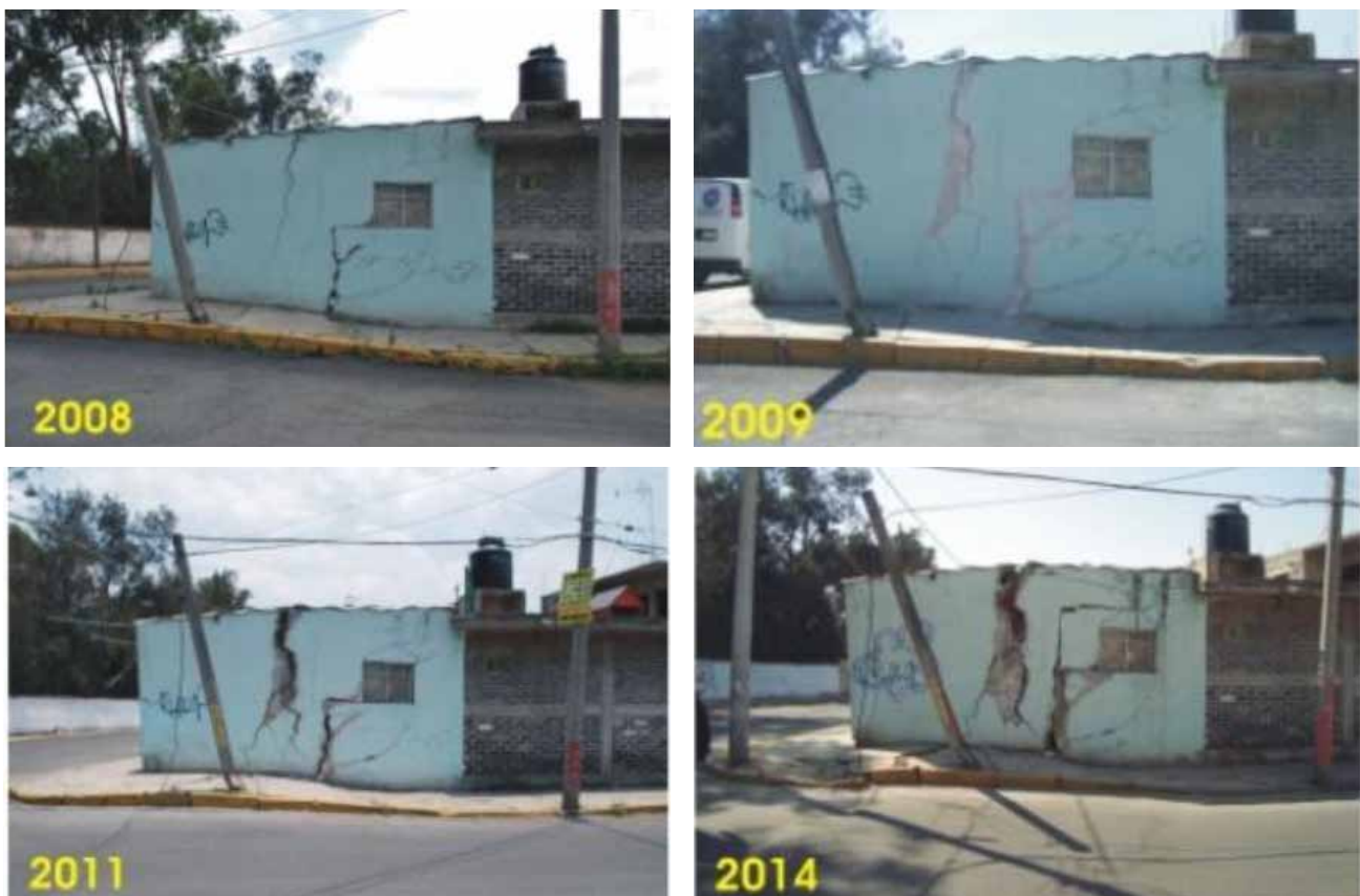
Fig. 4.3, Ejemplo de afectación por problemas de subsidencia y fracturamiento del Subsuelo. Calle Pedro Aceves Colonia San Sebastián Tecoloxtitlan.
