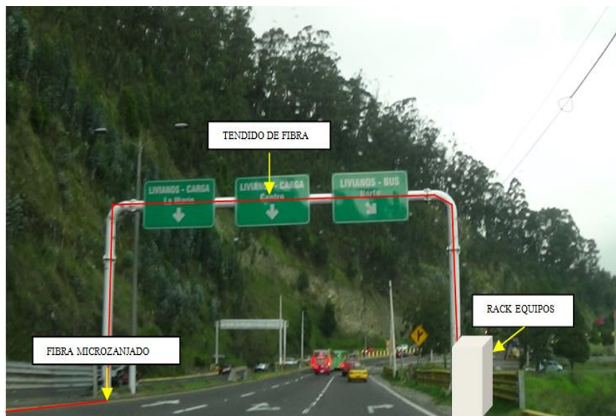
Figura 18. Ubicación del cuarto de equipos en el sector del trébol.
