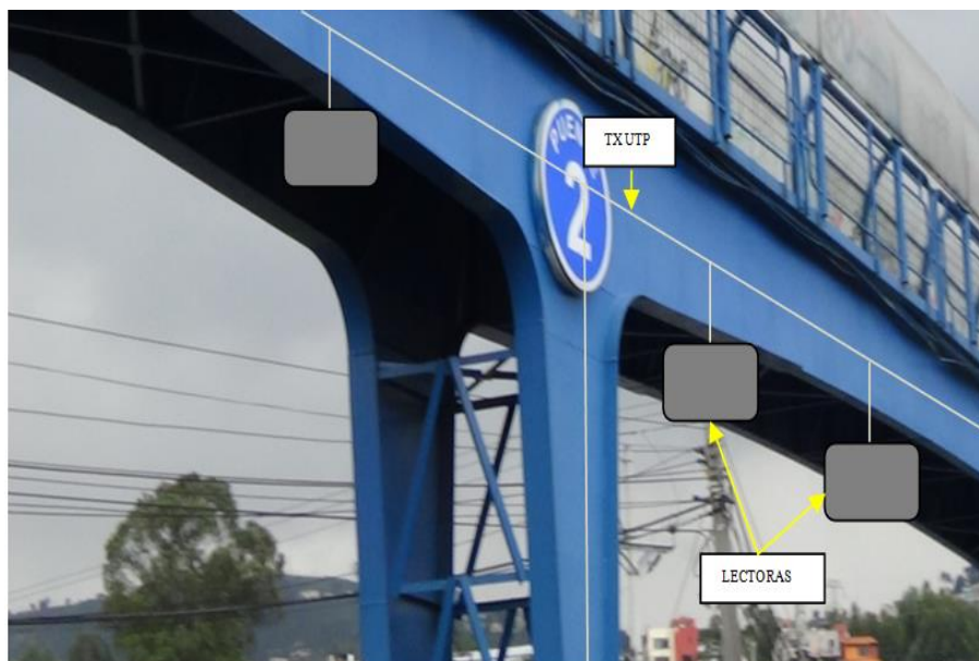
Figura 32. Ubicación de Equipos como de fibra en el Puente 2.
