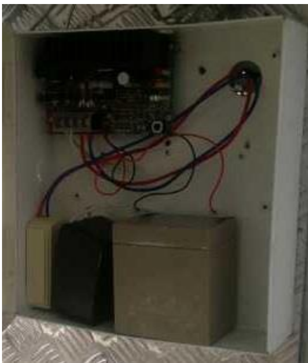
Figura 17. Fuente con respaldo de baterías.
