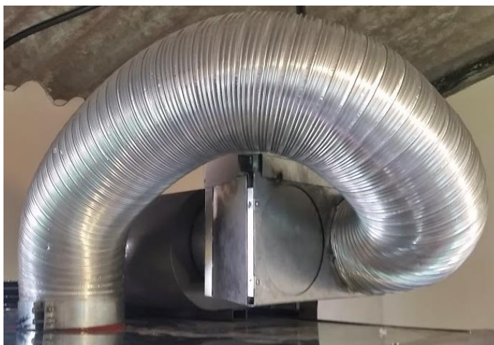
Figura 171 Sistema de renovación de aire montado
