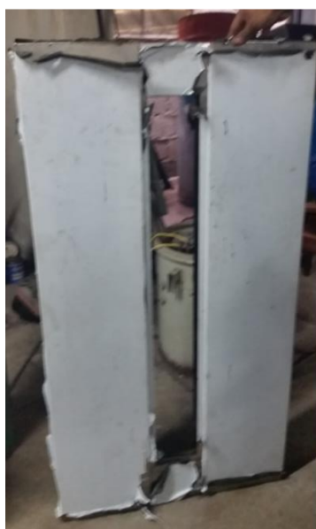
Figura 141 Puerta de la cámara de secado
