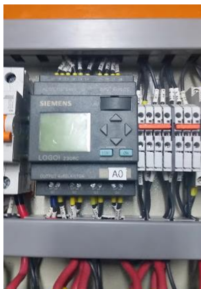
Figura 200 Montaje del PLC
