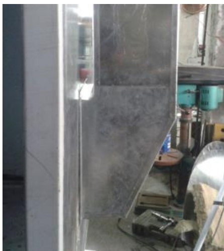
Figura 154 Codo de ingreso a la cámara de secado
