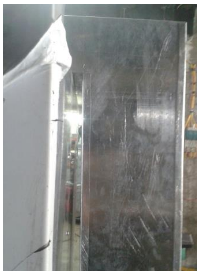
Figura 153 Codo entre salida del ventilador y ducto de entrada a la cámara
