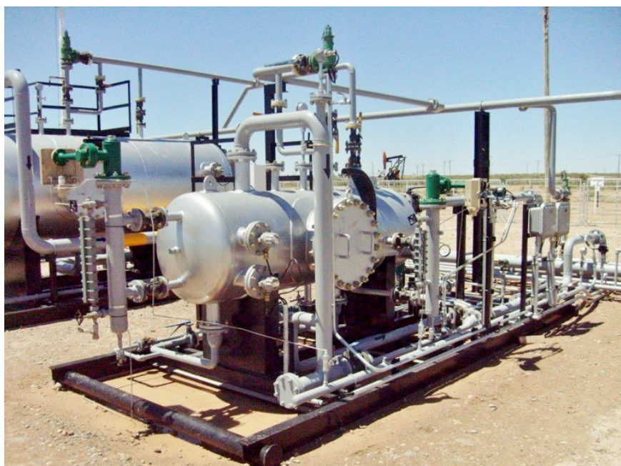
Figura 1: Separador trifásico en El Medanito –YPF, Argentina.
