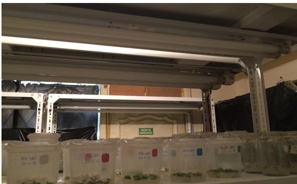
Figura 7. Lámparas Fluorescentes Colocadas por estantería.
