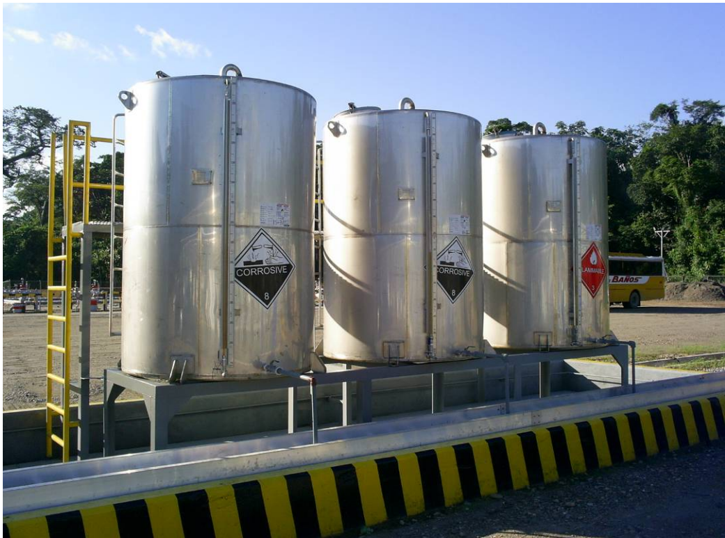
Figura 2.11 Tanques de almacenamiento de químicos para pozos de producción
