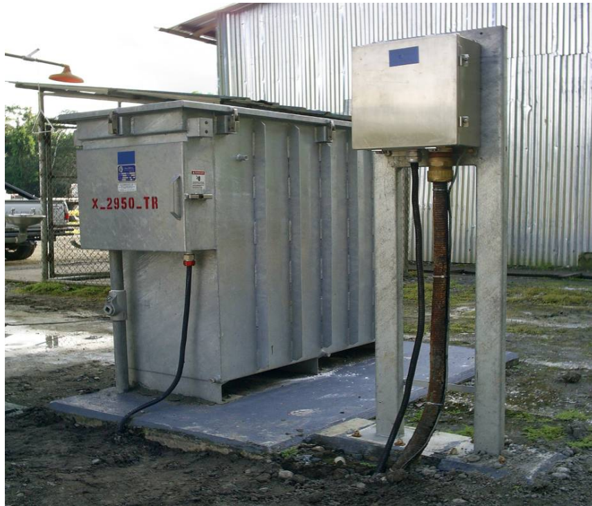
Figura 2.28 Exterior de un rectificador y caja de conexiones
