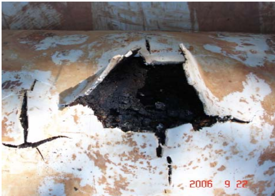
Figura 7.3 Daño del revestimiento por exceso de corriente de PC (2)
