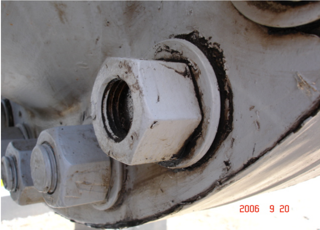
Figura 2.33 Estado de los pernos en juntas aislantes
