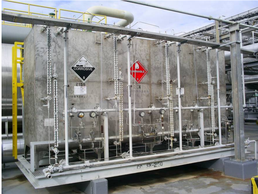
Figura 2.12 Tanques de almacenamiento de químicos para facilidades
