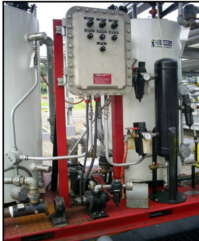
Figura 2.6 Sistema de bombeo para inyección de químicos en planta
