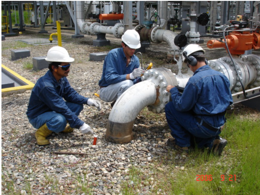
Figura 3.43 Medición de potenciales en juntas aislantes
