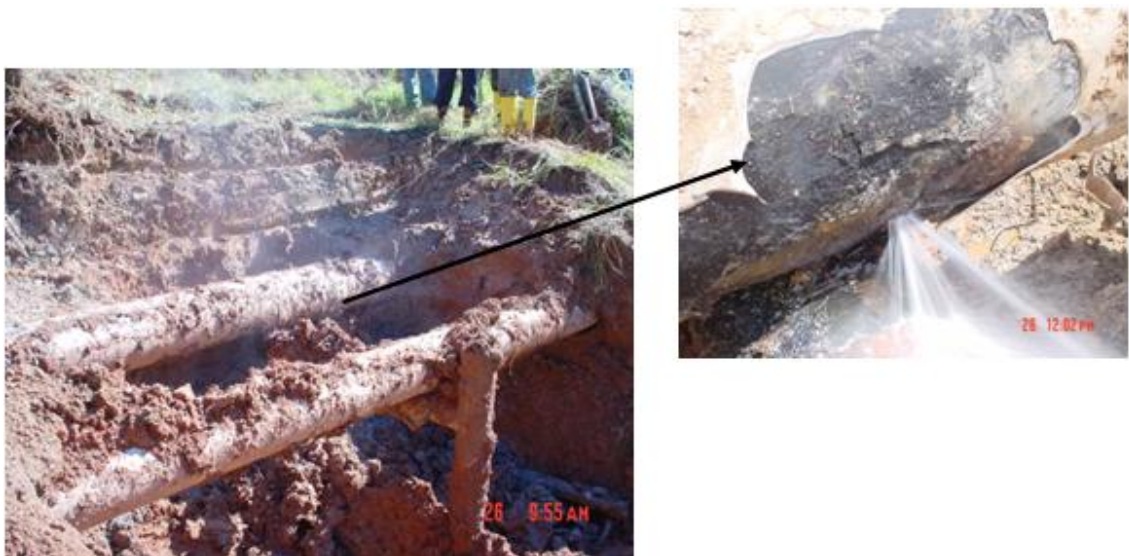
Figura 4.1 Defectos en el revestimiento de tuberías enterradas
