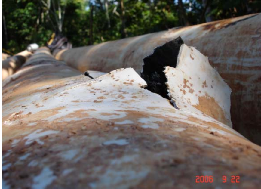
Figura 7.2 Daño del revestimiento por exceso de corriente de PC (1)
