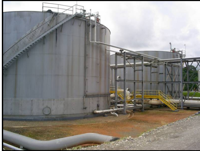
Figura 2.7 Tanques de almacenamiento para agua de producción
