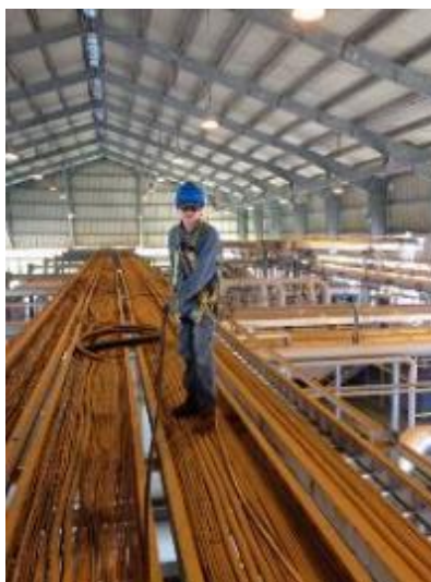
Figura 59: Tendido de Cable en Bandeja Aérea SSFD.
