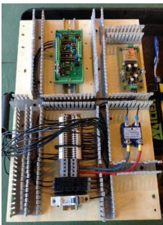
Figura 55: Cableado Tablero Eléctrico.
