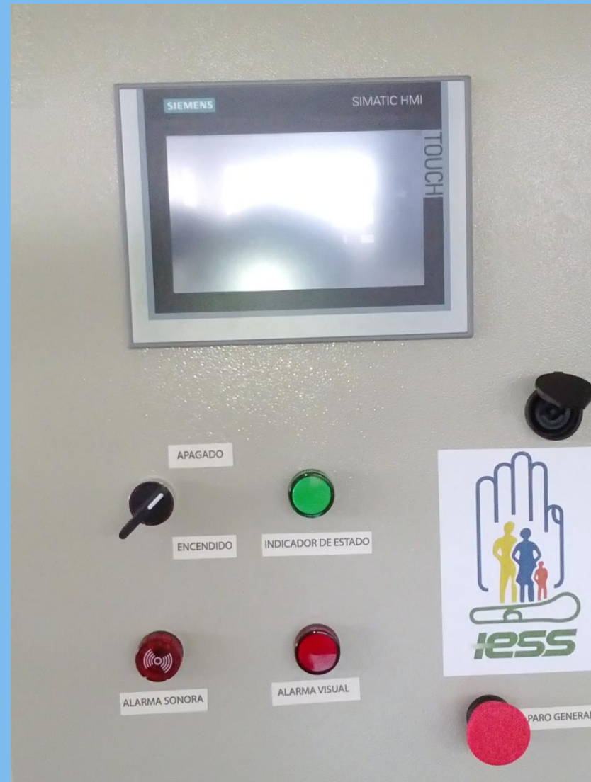
Estructura física del tablero de control
