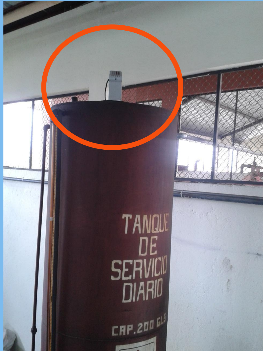
Indicador de nivel y Transmisor de Nivel
