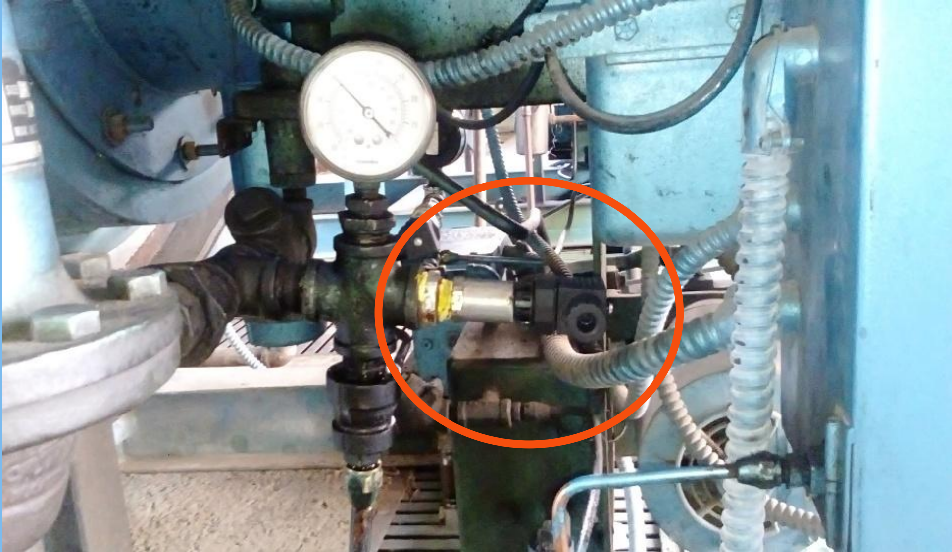
Manómetro y Transmisor de Presión de Diésel
