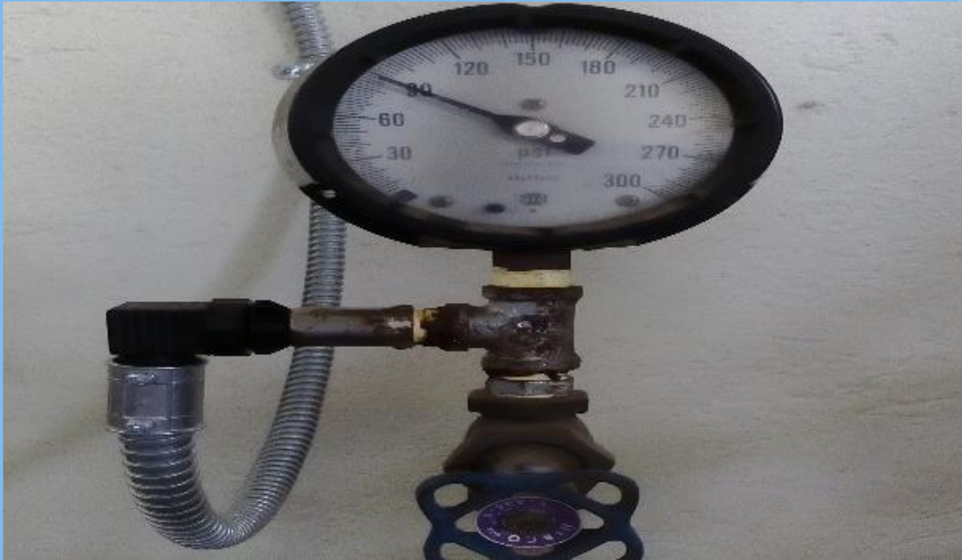
Manómetro y Transmisor de Presión del Banco de Distribución
