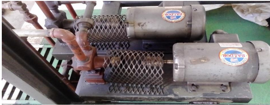
FIGURA Nº 77 Bombas de Presurización de Diesel
