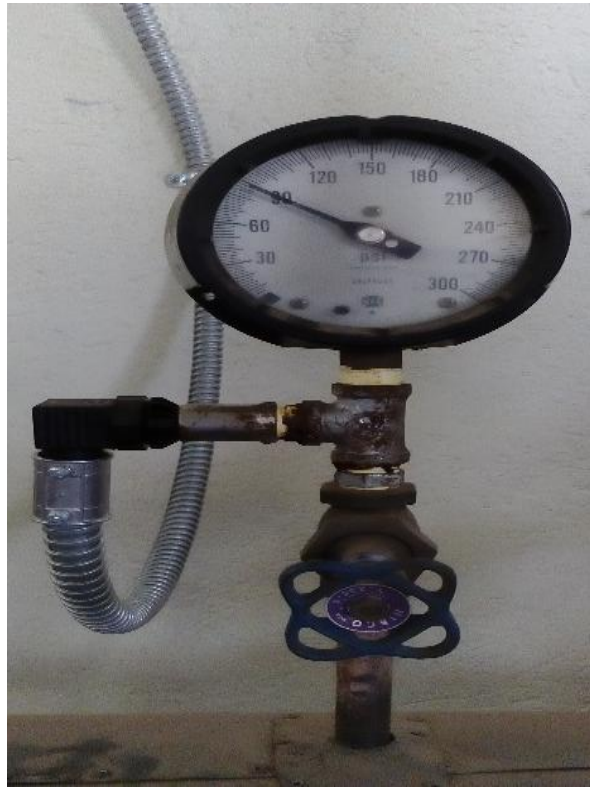
FIGURA Nº 74 Manómetro y Transmisor de Presión del Banco de Distribución
