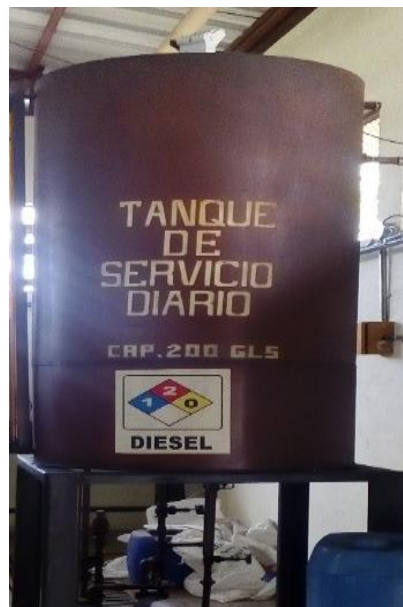
FIGURA N° 76 Tanque de Suministro Diario
