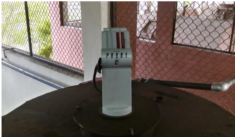
FIGURA N° 79 Transmisor de Nivel Montado en Campo
