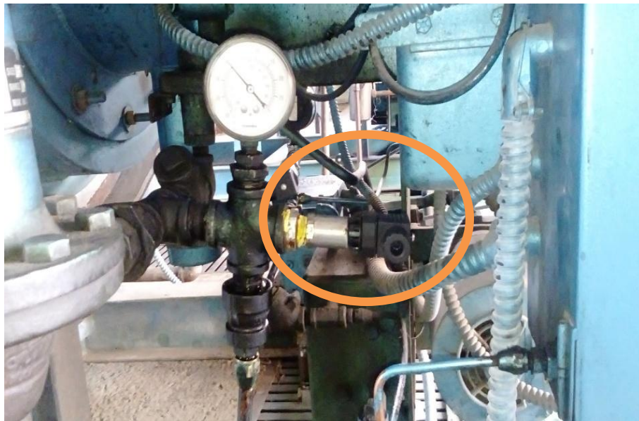
FIGURA N° 71 Manómetro y Transmisor de Presión de Diesel Instalados
