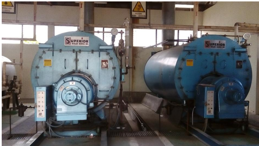
FIGURA Nº 70 Vista Frontal de las Calderas
