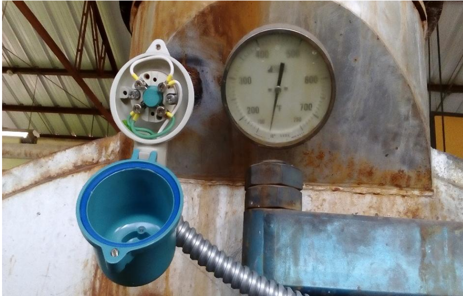
FIGURA N° 75 Manómetro y Sensor de Temperatura de la Chimenea
