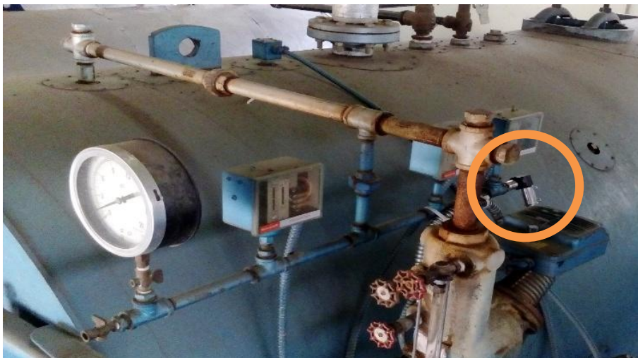
FIGURA Nº 73 Manómetro y Transmisor de Presión de Trabajo Instalados
