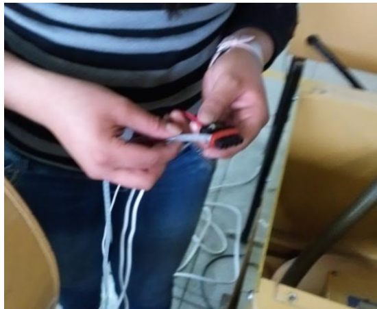
Figura 50 Cableado de sensor MAF hasta armario eléctrico
