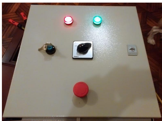
Figura 41 Vista frontal armario eléctrico
