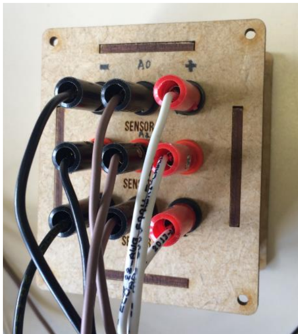
Figura 52. Conexión de sensores.
