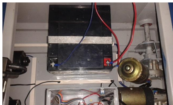
Figura 45. Ubicación y anclaje de batería
