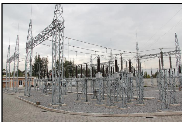
Figura 61 Subestación de transferencia Alangasí
