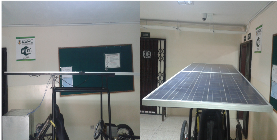
Figura 4.3: Instalación Física de Paneles Fotovoltaicos
