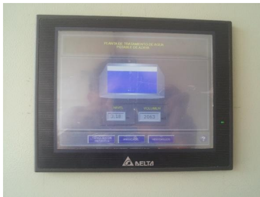
Figura 97. Interfaz HMI en funcionamiento
