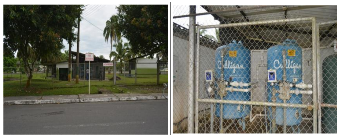
Figura 49: Planta de tratamiento de agua potable.
