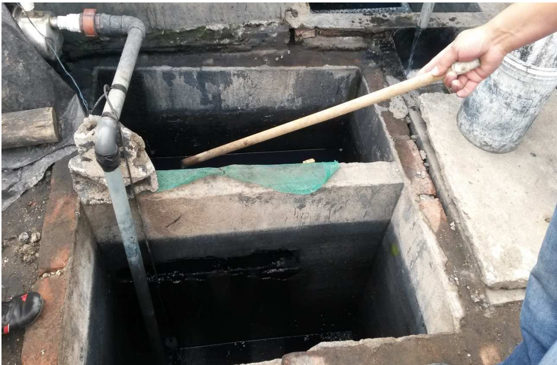
Tanques de planta de tratamiento
