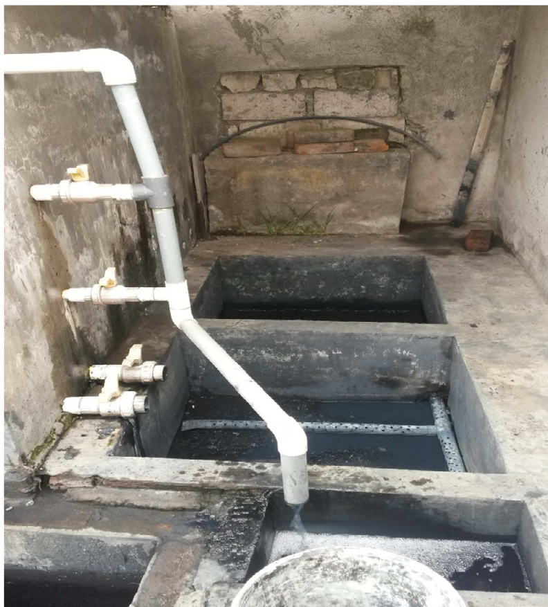
Descargas de aguas residuales
