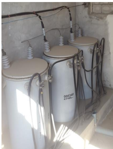
Figura 19. Transformadores eléctricos en la ESMA.
