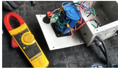
Figura 95. Pruebas de potencia
