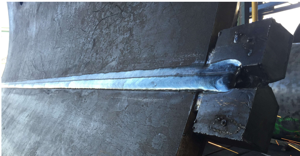
Fotografía 8 Cordón de relleno en el Cuerpo del Auto Tanque
