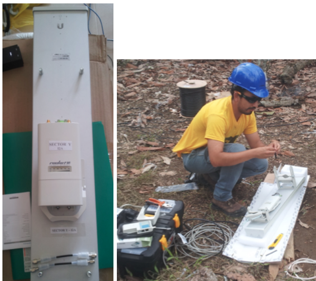
Figura 5.2: Instalación de Puntos de Acceso RocketM5.
