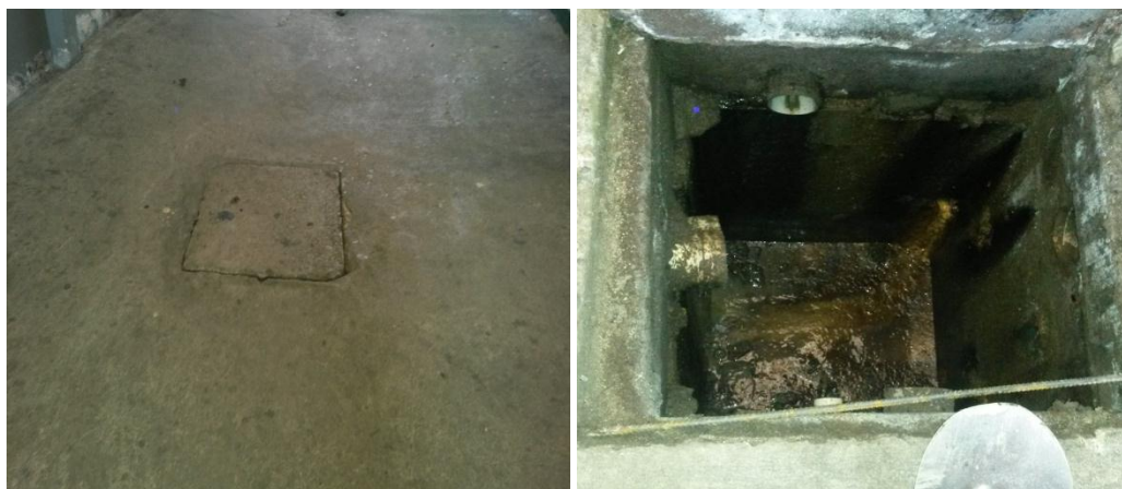
Figura 62. Cajas de revisión previa a la descarga. Fuente: Sánchez B., Villamarín V.; 21/10/2015
