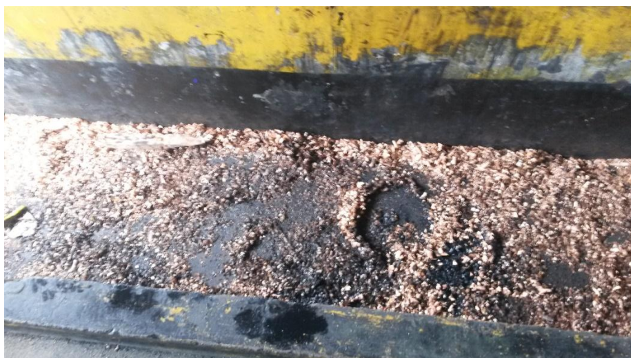
Figura 44. Contención de aceite derramado con aserrín Fuente: Sánchez B., Villamarín V.; 21/10/2015
