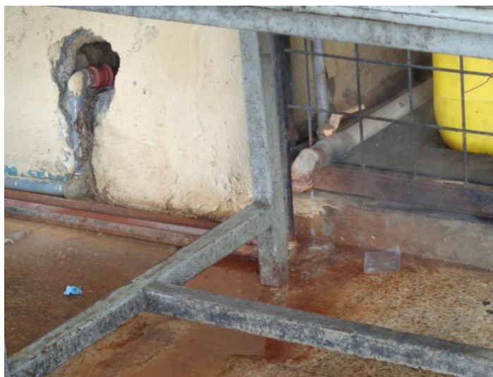
Figura 40. Fugas de agua y gas provenientes de las calderas Fuente: Sánchez B., Villamarín V.; 21/10/2015
