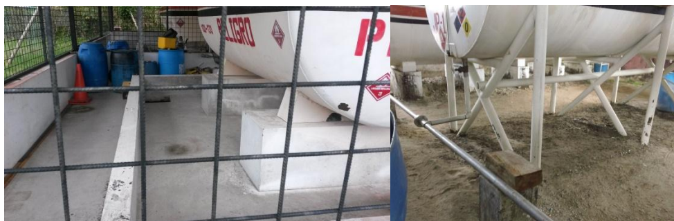
Figura 48. Presencia y ausencia de cunetas en los tanques de almacenamiento Fuente: Sánchez B., Villamarín V.; 21/10/2015
