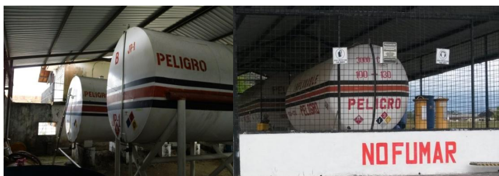
Figura 50. Rombos de Seguridad ubicados en tanques de almacenamiento Fuente: Sánchez B., Villamarín V.; 21/10/2015
