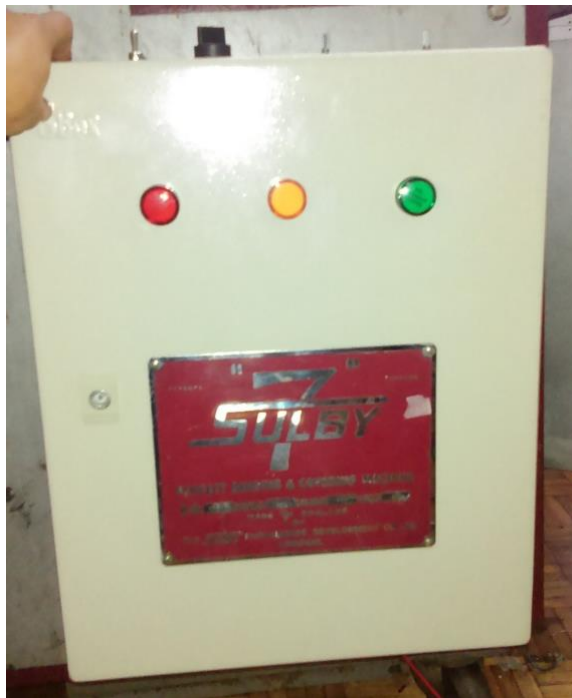
Figura 53 Vista frontal de la caja eléctrica de control
