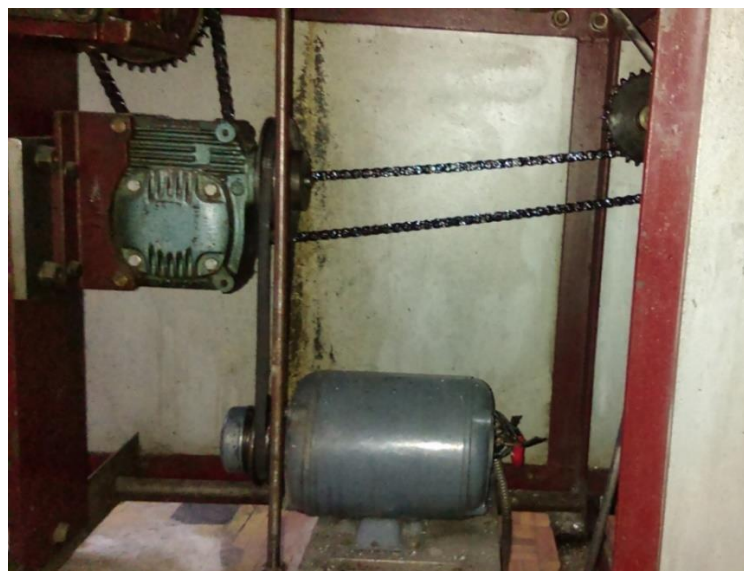
Figura 28 Ubicación del motor principal de la máquina encoladora
