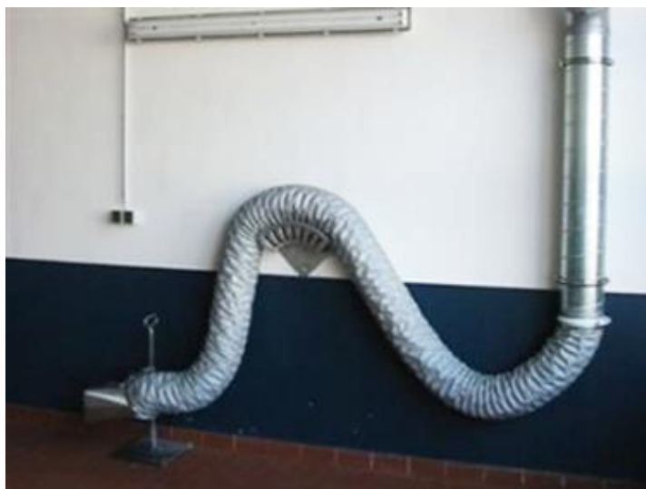
Figura 38. Sistema de extracción de gases.
