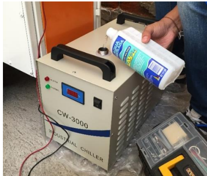
Figura 82. Suministro de agua destilada al enfriador de agua
