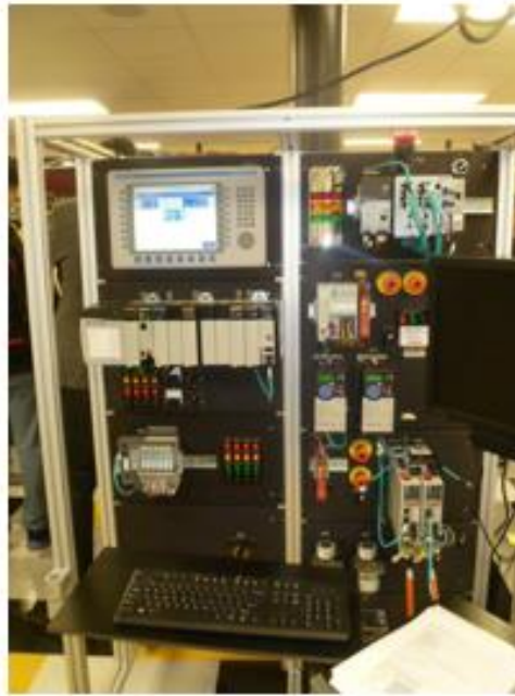
Figura 16. Vista Frontal de un sistema de entrenamiento Allen Bradley del laboratorio de “Electrical Engineering - University of Michigan”
