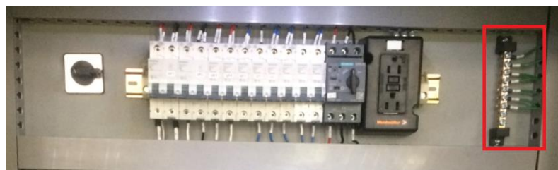
Figura 56. Barra común de Puesta a Tierra
