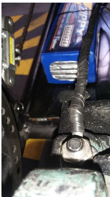
Figura 69 Cableado de baterías motor
