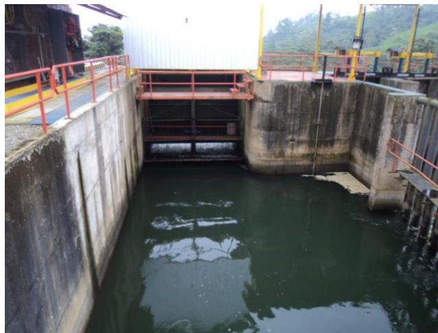
Figura 17 Canal de control central Hidroeléctrica Calope
