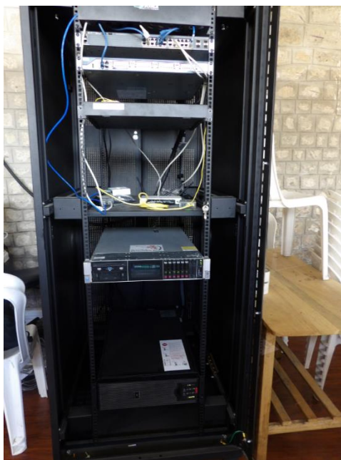
Figura 47. Equipamiento activo Central de Monitorización.
