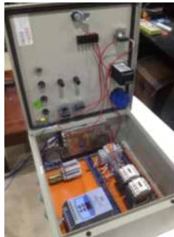
Figura 92: Conexionado de tablero
