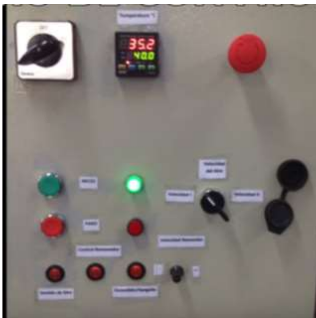
Figura 93: HMI de tablero de control
