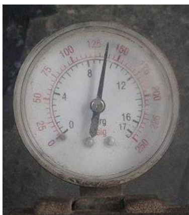
Figura 50. Presión marcada por manómetro en la línea de suministro.
