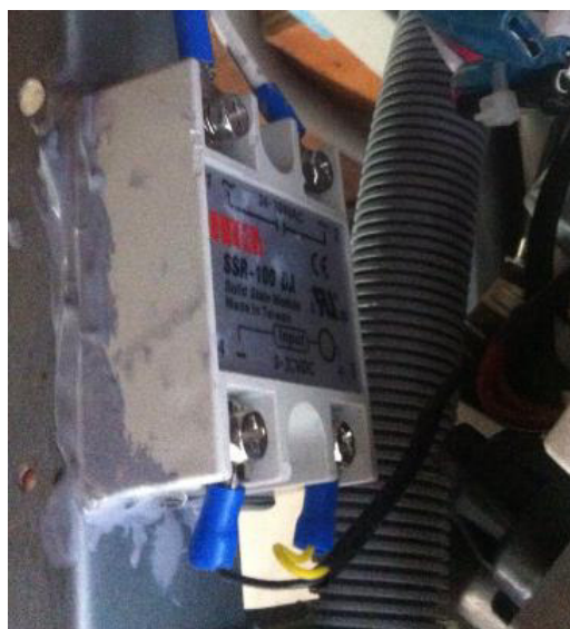
Figura 92.- SSR implementado con pasta térmica y anclado a la estructura
