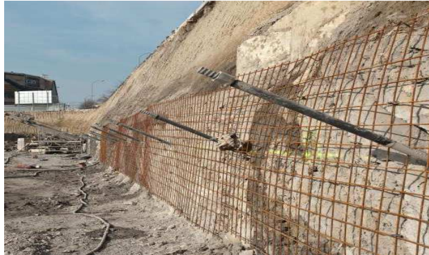
Figura 33 Anclaje en talud
