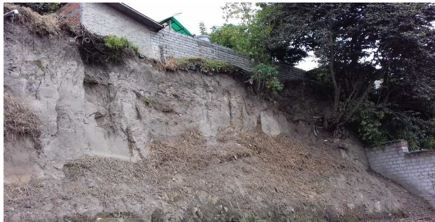
Figura 73 Talud No 3 en zona de riesgo
