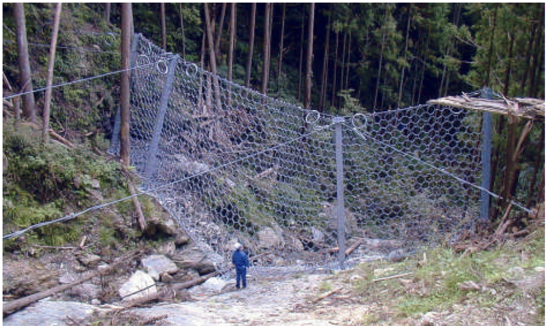
Figura 41. Barrera flexible para retención de flujo de lodos en Tobinosu, Japón.
