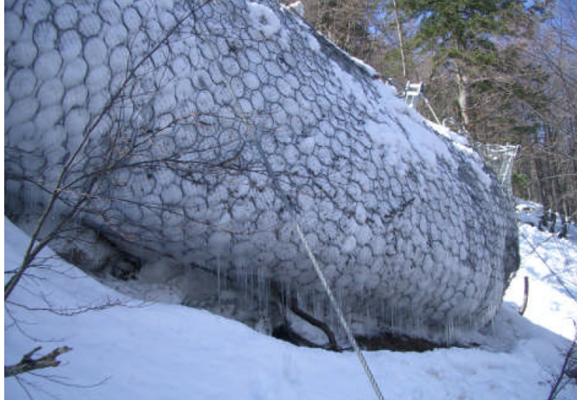
Figura 46. Barrera flexible contra avalancha de nieve.
