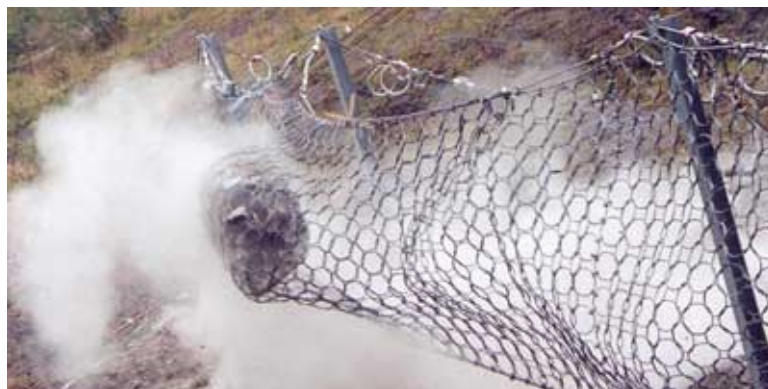
Figura 47. Barrera flexible contra caída de rocas.
