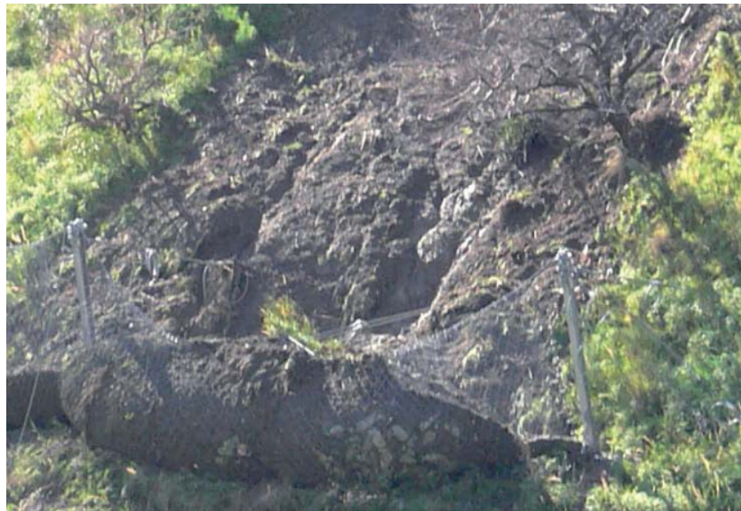
Figura 45. Malla flexible para contra deslizamiento de tierra.
