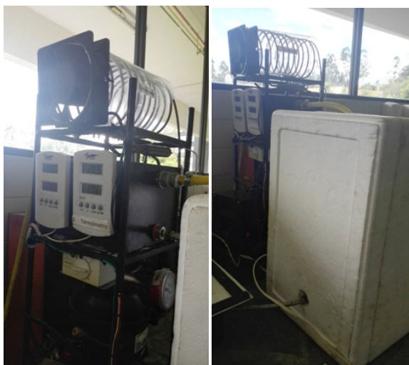
Figura 42. Sistema de enfriamiento
