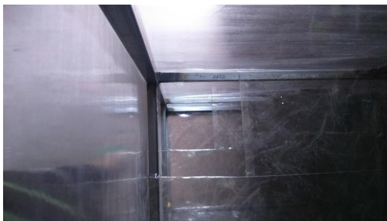
Figura 39 Ducto de ventilación del sistema
