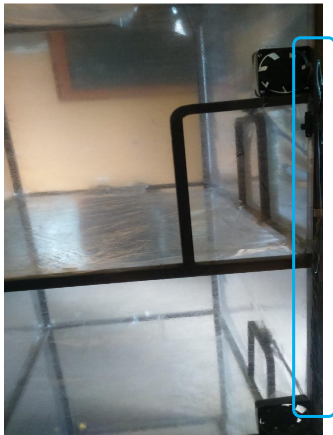
Figura 38 Cableado de ventilador
