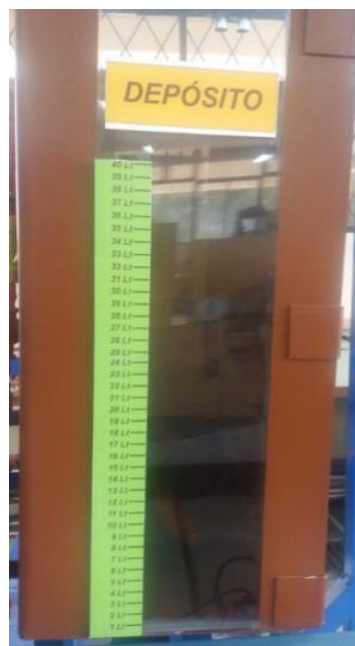
Figura 40 Depósito instalado en el módulo
