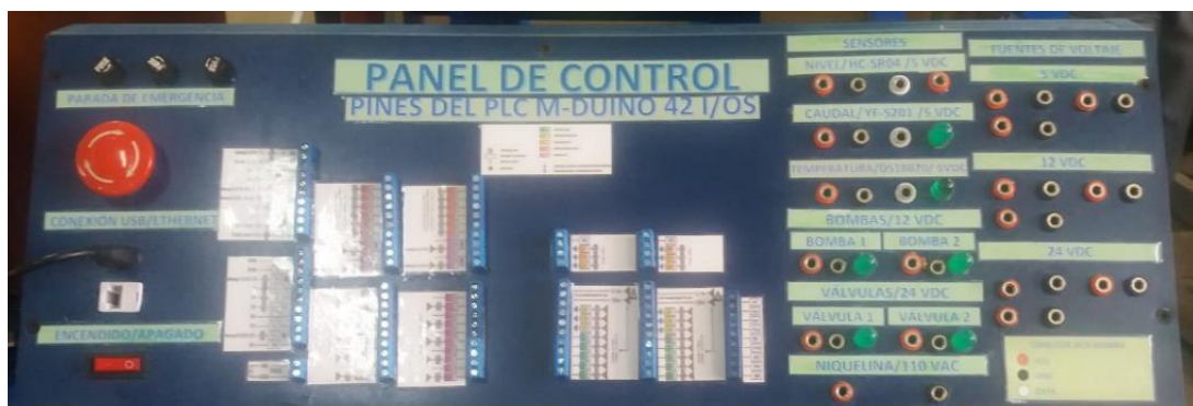
Figura 66 Panel de control instalado en el módulo
