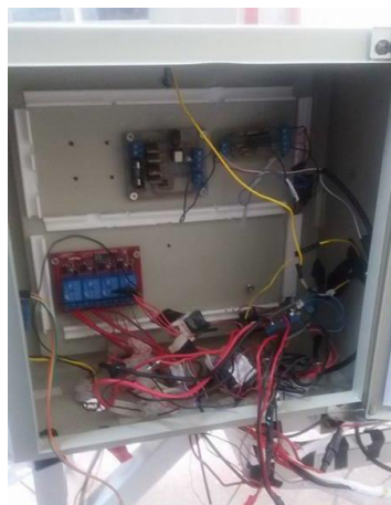
Figura 28 Caja de Control – Estado Inicial
