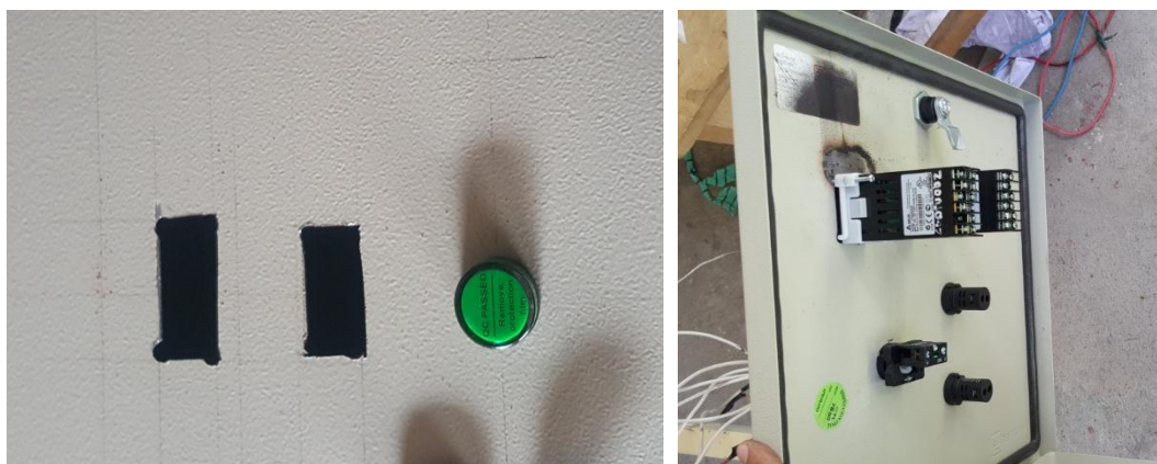
Figura 52 Vista exterior de tablero implementado
