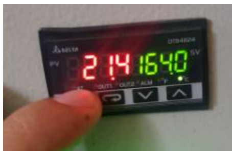
Figura 74 Configuración del controlador de temperatura
