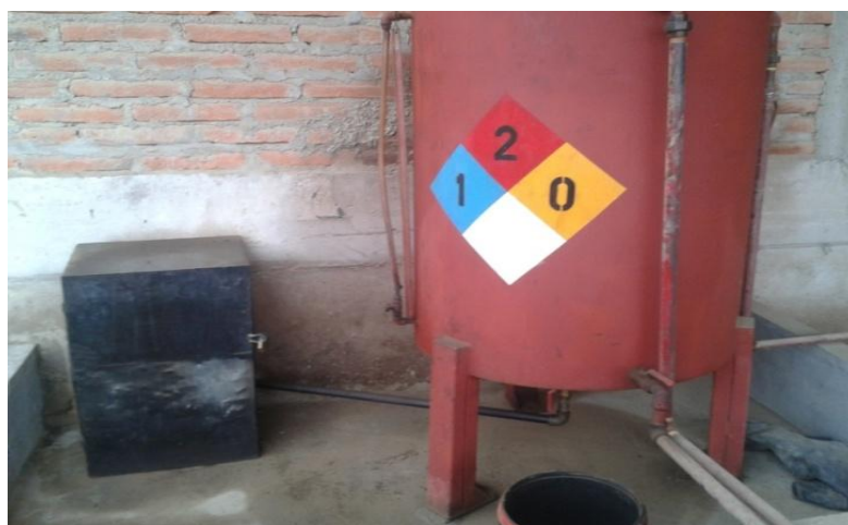
Figura 25. Tanque de combustible
