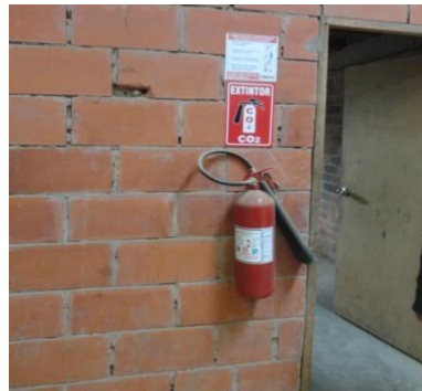
Figura 28. Equipos contra incendios
