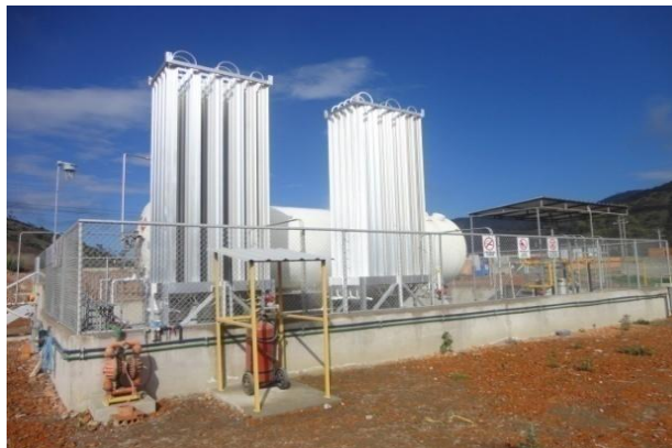
Figura 30. Almacenamiento de GNL
