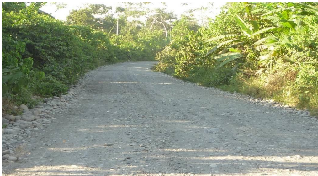
Figura 13 Estado actual de la vía Km. 2+500.
