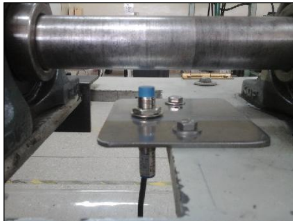
Figura 121. Sensor de distancia instalado
