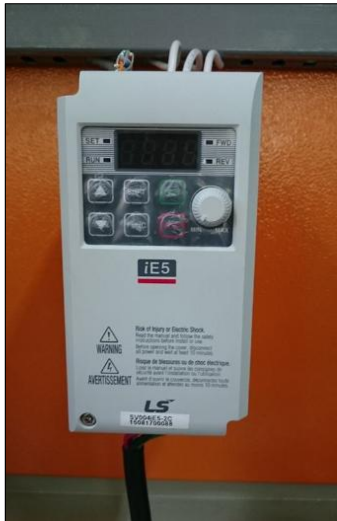
Figura 149. Variador de frecuencia instalado
