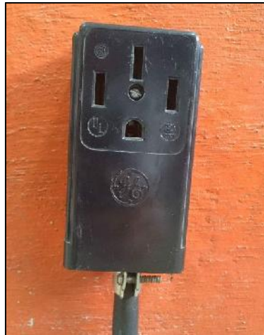
Figura 133. Toma trifásica - Laboratorio
