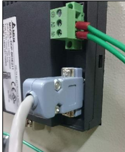
Figura 139. Instalación RS-485 en HMI
