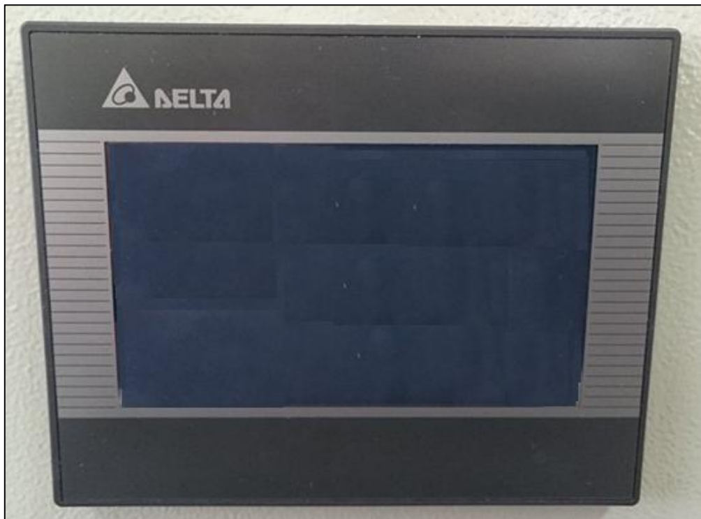
Figura 148. Pantalla táctil HMI instalada
