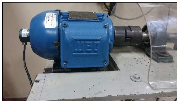
Figura 118. Motor instalado sobre el soporte
