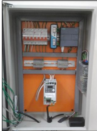
Figura 117. Interior de la caja de control
