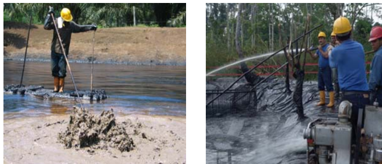
Figura 11 Presión de agua a piscinas contaminadas
