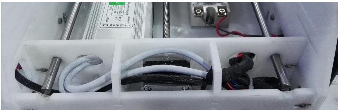
Figura 91 Cableado de fuente de alimentación.
