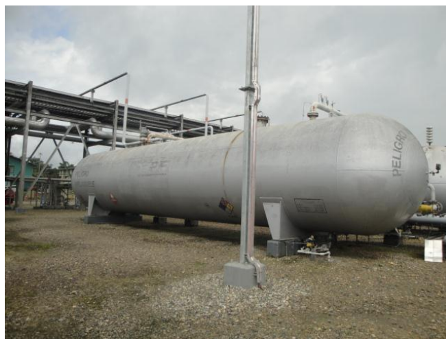
Figura 6 Tubería de salida de los acumuladores de gas
