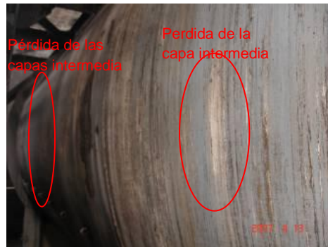
Fotografía 2: Estado de la pintura externa
