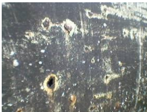
Figura 13 Apariencia corrosión bajo aislamiento CUI
