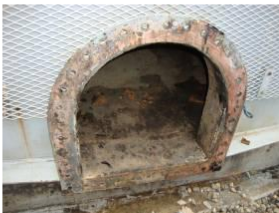
Figura 12 Apariencia corrosión por cavitación
