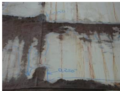
Fotografía 2. Identificación de zonas y medición de pittings
