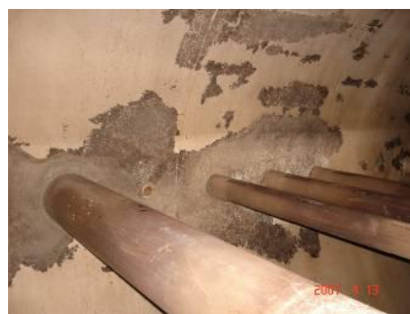
Fotografía 8: Estado de la pintura de la parte superior del vessel
