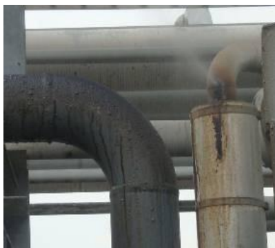
Figura 11 Apariencia corrosión por erosión salida separador de prueba
