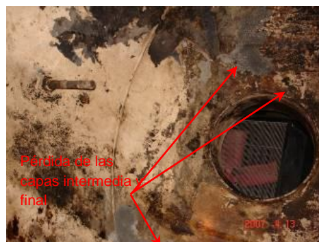
Fotografía 4: Estado de la pintura interna del recipiente del lado del manhole oeste
