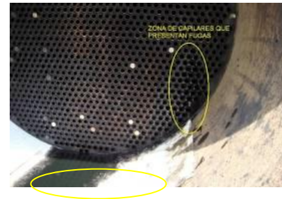
Fotografía 2. Identificación de fuga en capilares
