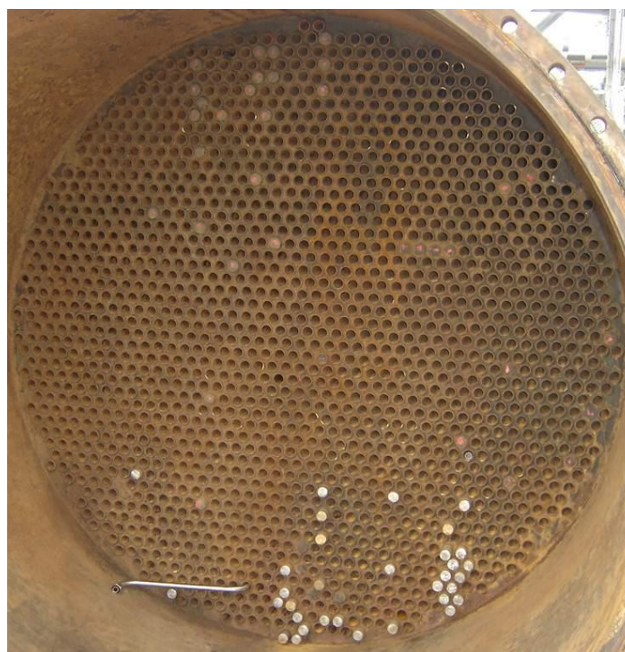
Figura 31 Intercambiador de calor E-1204
