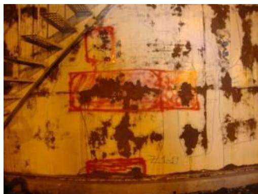
Fotografía 7. Marcación de zonas a ser reparadas.
