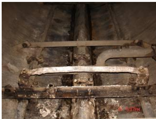
Figura 14 Apariencia corrosión galvánica soporte separador de producción
