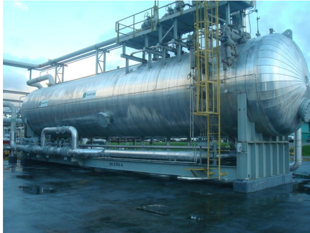
Figura 5 Tubería aislamiento térmico salida fluido separador de agua libre
