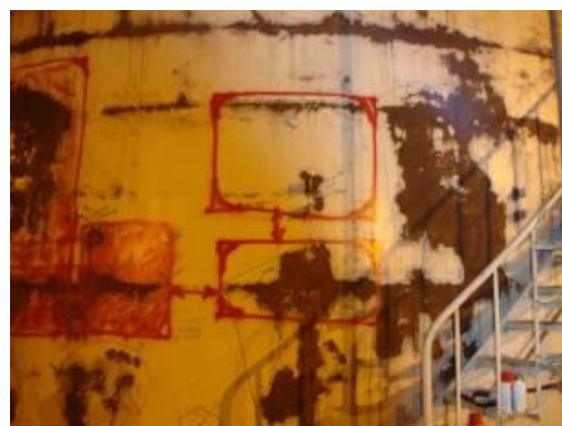
Fotografía 6. Marcación de zonas a ser reparadas
