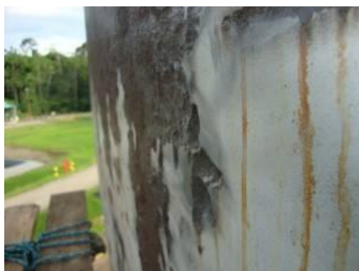
Fotografía 3. Identificación de zonas y medición de pittings
