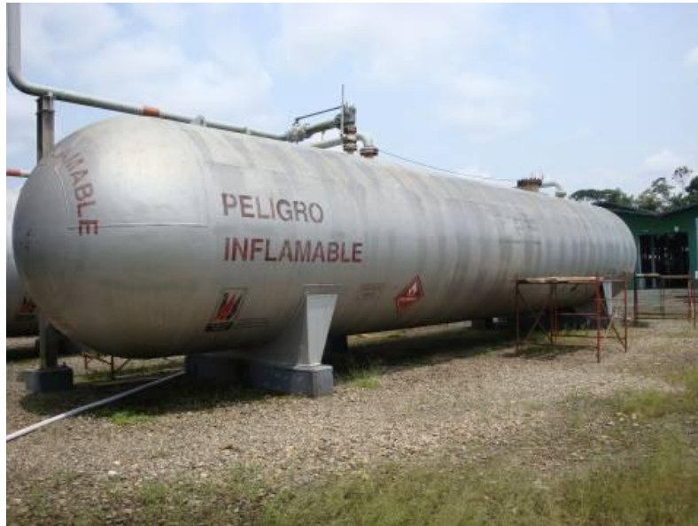
Figura 22 Acumulador de gas V-3012
