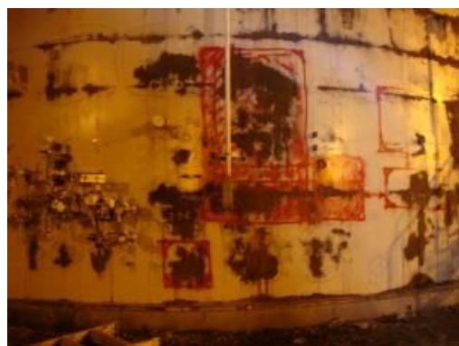
Fotografía 5. Marcación de zonas a ser reparadas
