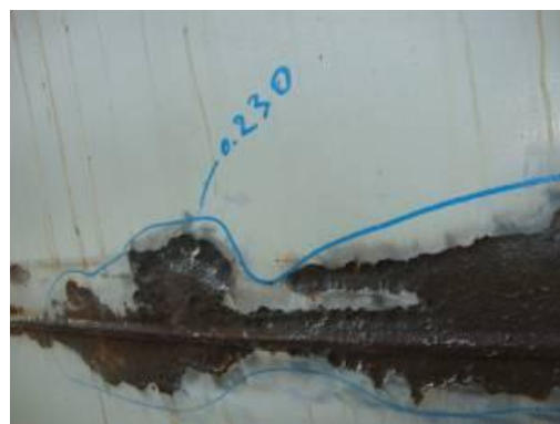
Fotografía 4. Identificación de zonas y medición de pittings
