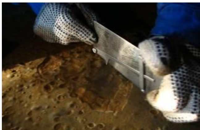
Figura 15 Apariencia corrosión inducida por microorganismos tanque almacenamiento de agua
