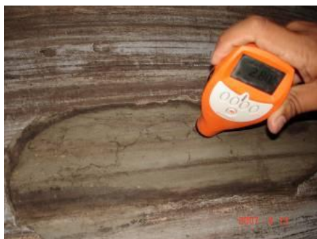
Fotografía 3 : Perdida de las capas intermedia y final de pintura externa
