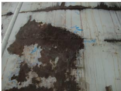
Fotografía 1. Identificación de zonas y medición de pittings
