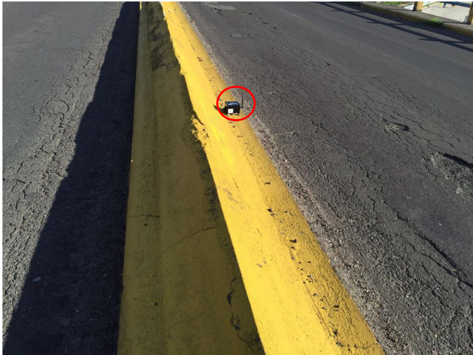
Figura 74 Ubicación de Sensores en Parterre Tramo 2
