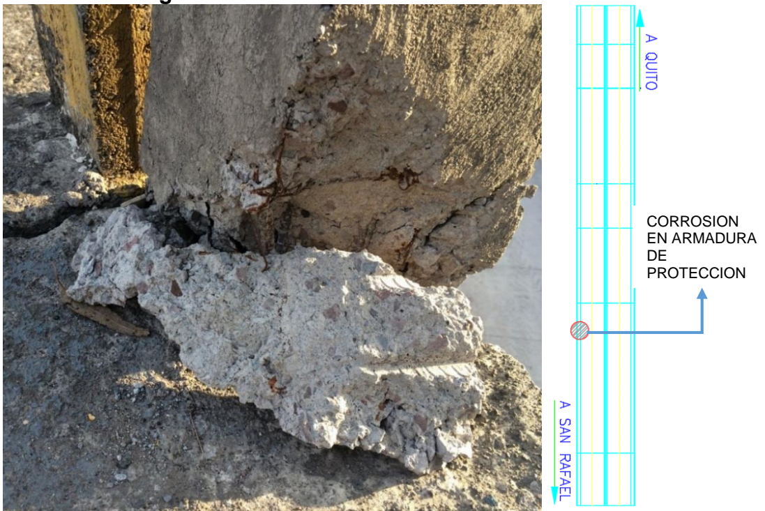
Figura 38 Corrosión de la armadura de en las Protecciones
