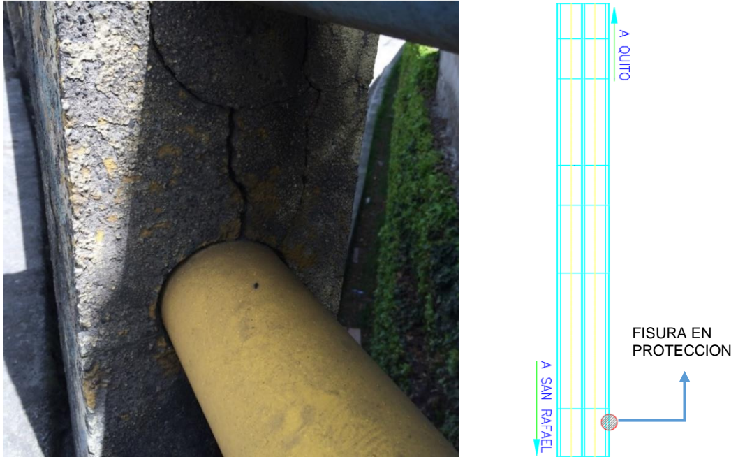
Figura 30 Fisuras en Protecciones
