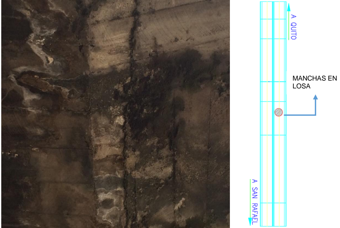
Figura 34 Manchas en el Bore Inferior de la Losa
