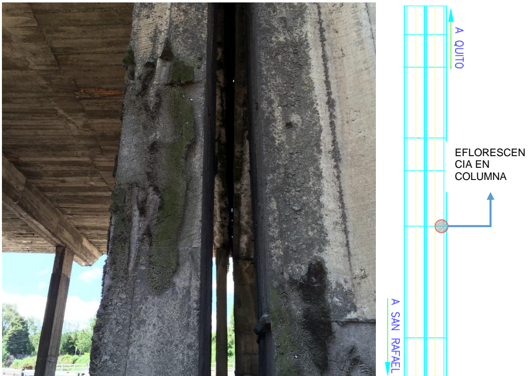
Figura 32 Eflorescencias en Columnas
