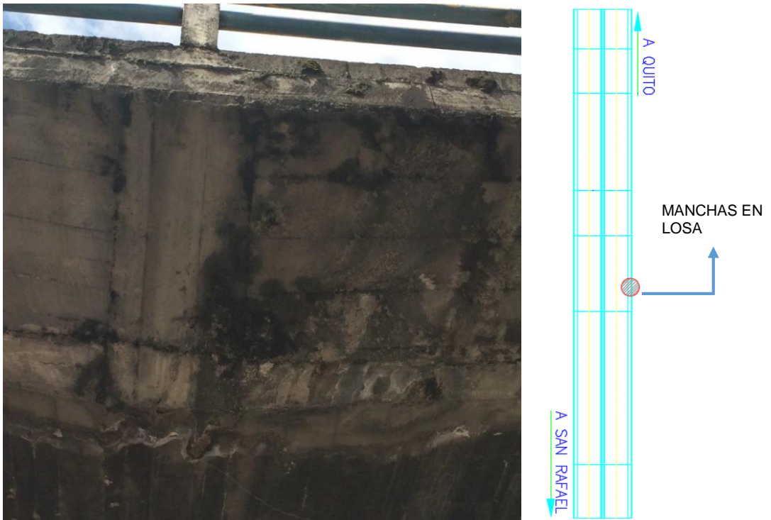
Figura 35 Manchas en el Bore Inferior de la Losa
