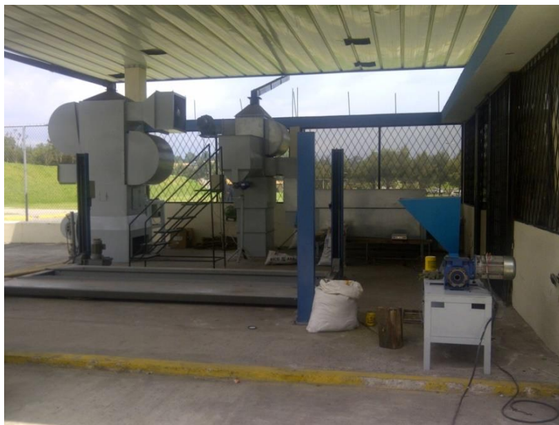
Figura 28 Vista interna de la línea de combustión de biomasa
