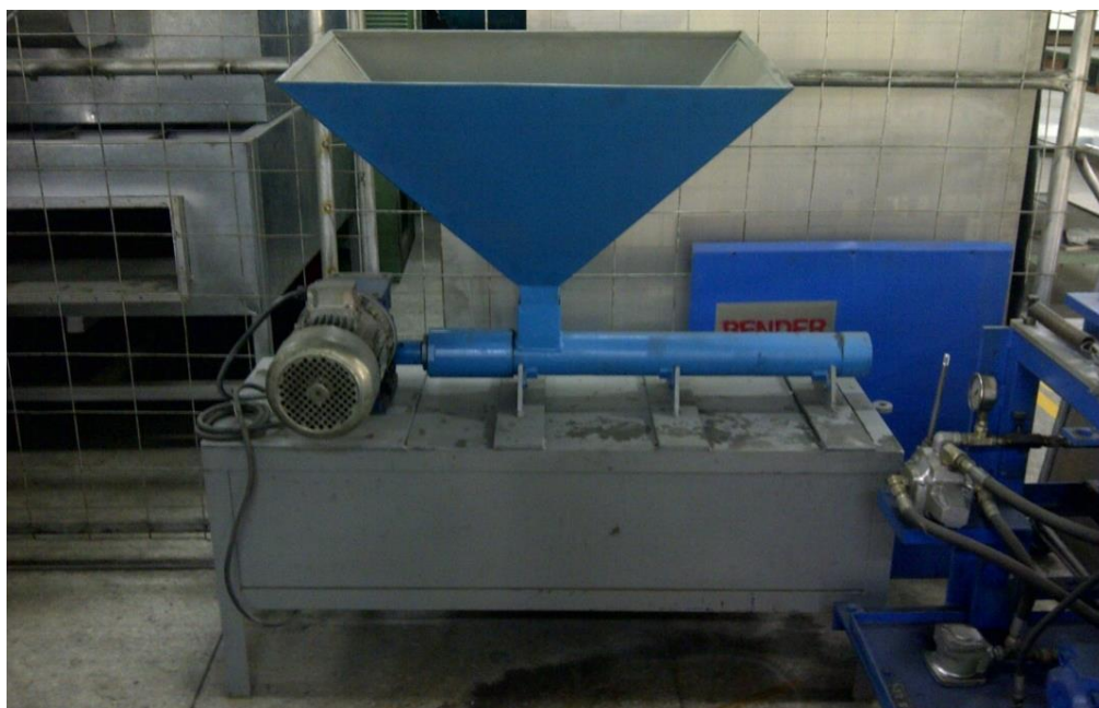
Figura 25 Briquetadora en estado inicial
